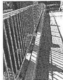
安全柵整備(立花町)
