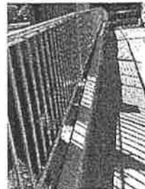
安全柵整備(立花町)
