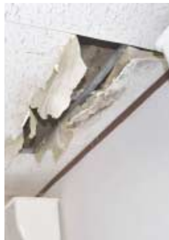
雨漏り等で穴が開いた学校トイレの天井
