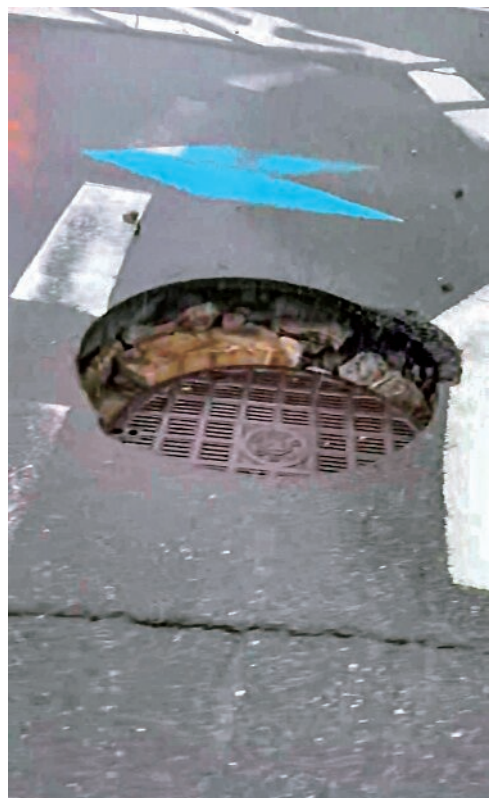
6月26日大雨時の小阪北口交差点内の道路陥没発生状況
