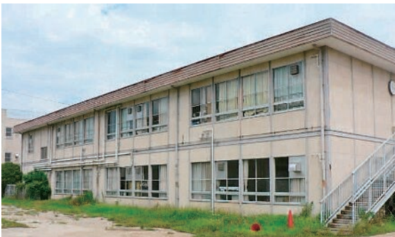
八尾支援学校の耐用年数を越えたプレハブ校舎は窓も閉まりにくくトイレもない
