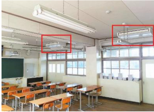
早期整備が望まれる小学校教室の空調設備
