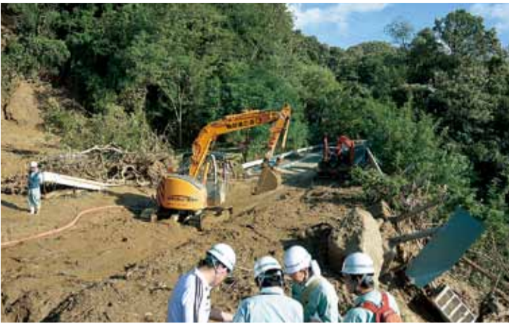
土砂災害の復旧作業状況
